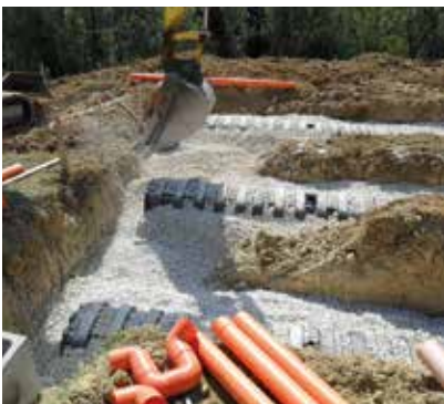
④ COBERTURA Inserción de las tuberías de suministro y ventilación. Cover with min. Cubrir con min. 15-20 cm de grava de 20/40 mm.
